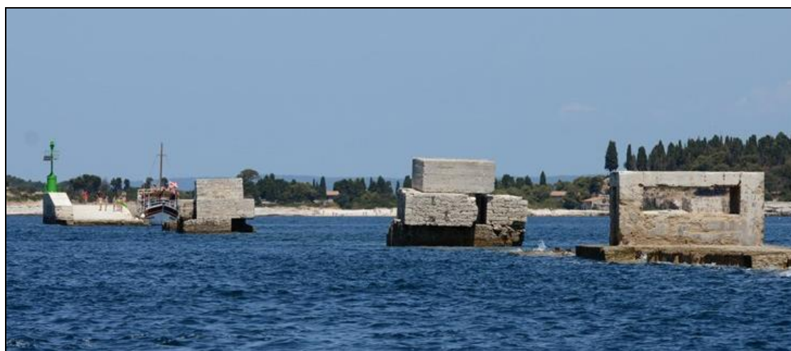
Slika 35 Porušeni dio na glavi lukobrana luke Pula (2)
